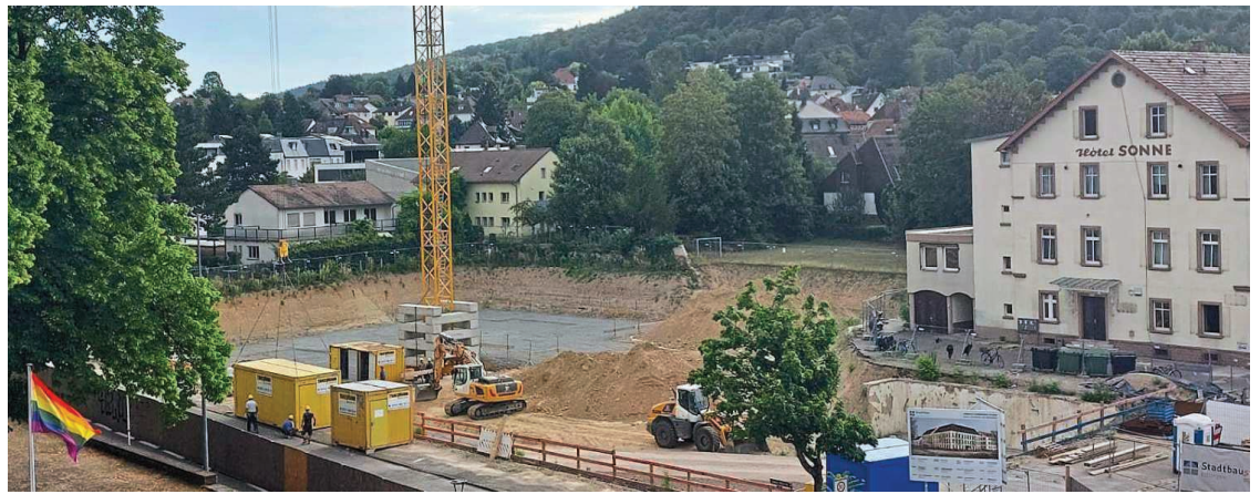
Geht allmählich voran: Bei der Neubebauung des alten Feuerwehrgehäuses in der Pforzheimer Straße wird aktuell die Bodenplatte für die Tiefgarage betoniert. Alllasten im Boden hatten zu einer Verzögerung des Projekts geführt. An dem Standort sind Mietwohnungen und ein Verwaltungsgebäude geplant. Foto: Stadtbau GmbH
