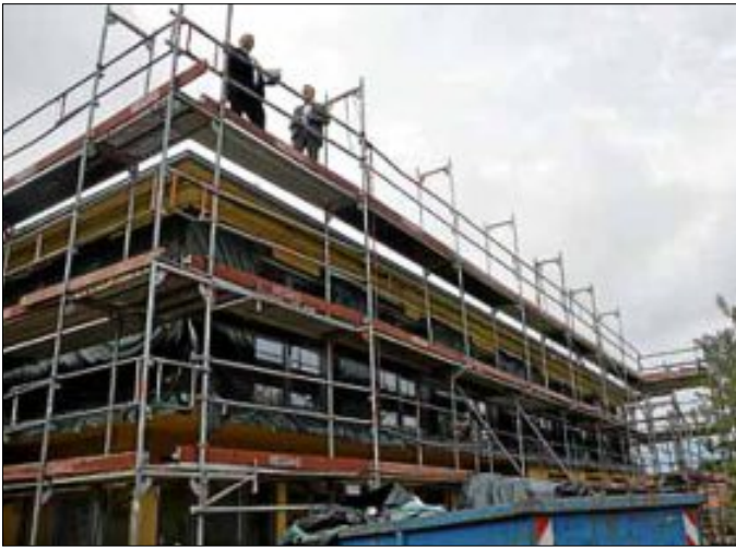
Zimmermann Fritz Dittus beim Richtspruch für das Mehrgenerationenhaus in Schöllbronn, das zunächst als Anschlussunterbringung für Asylbewerber dient.
