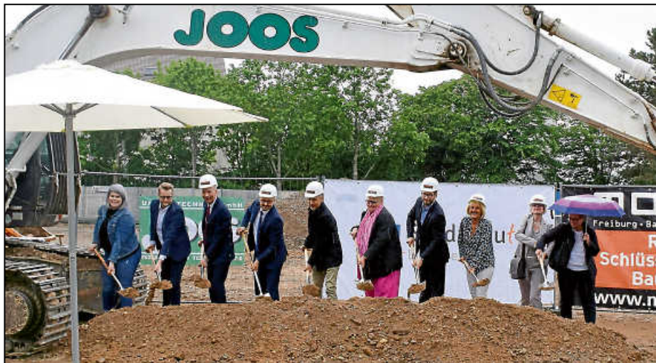
Historischer Tag für die Stadtochter Stadtbau GmbH: auf dem Gelände des ehemaligen Festplatzes fand der erste Spatenstich für das große Bauvorhaben „Generationenpark“ statt.
