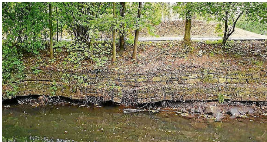
Die Gabionen des Albufers im Bereich Damaschkesteg/Eto-Wehr lösen sich auf, der Bereich muss saniert werden. Foto: Ing. Büro Queißer
