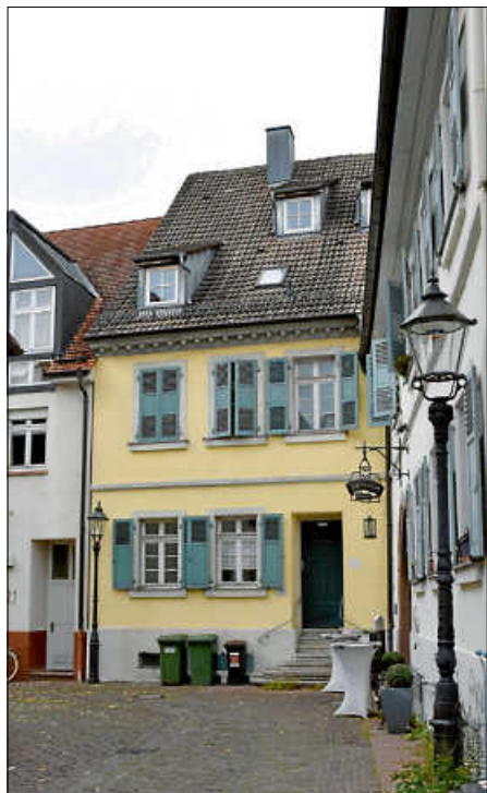
Das Anwesen Lauergasse 23 ist in keinem guten Zustand. Die Mängel reichen vom fehlenden Brandschutz über konstruktive Defizite bis zum Schädlingsbefall von Holzbalken.
