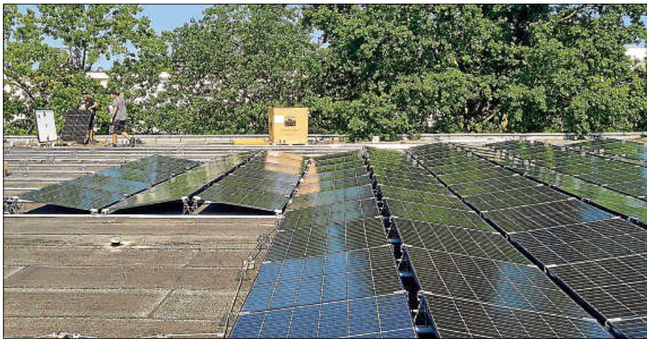
Eine von drei Photovoltaikanlagen, die die BEG 2022 realisierte, ist die Anlage auf dem Dach des Eichendorff-Gymnasiums mit einer Leistung von 135 Kilowatt Peak.
