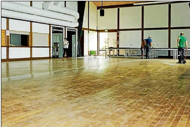
Der Hallenboden hat unter einem Wasserschaden erheblich gelitten.
