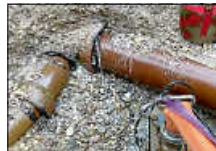
Aus dem Kanal fließt das Abwasser ins Erdreich, im Felchenweg.
