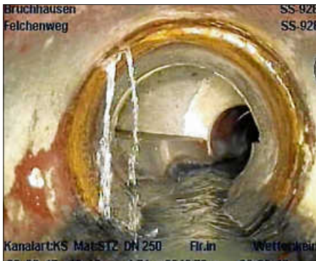
Wasser dringt in den Kanal ein, wie hier im Felchenweg in Bruchhausen.
