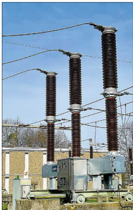
Leistungsschalter im Umspannwerk „Hagbruch“
