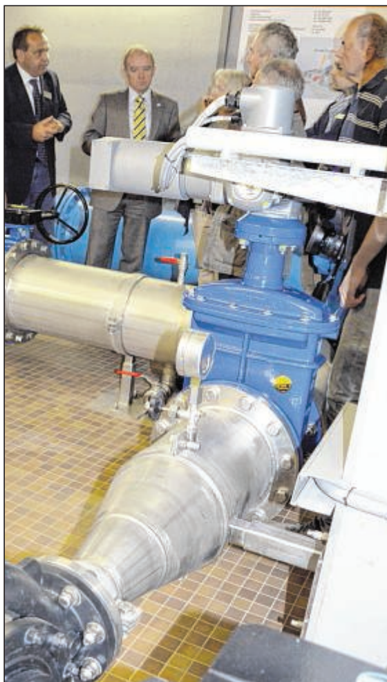
DIE PUMPTURBINE im Moosalb-Behälter hat den Probebetrieb bestanden. Foto: pr
