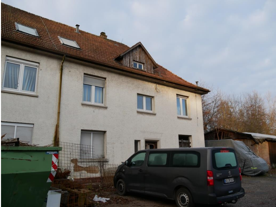
Abb. 7: Marode Wohnhäuser und Schuppen mit Dachöffnungen, Nischen und Spalten
